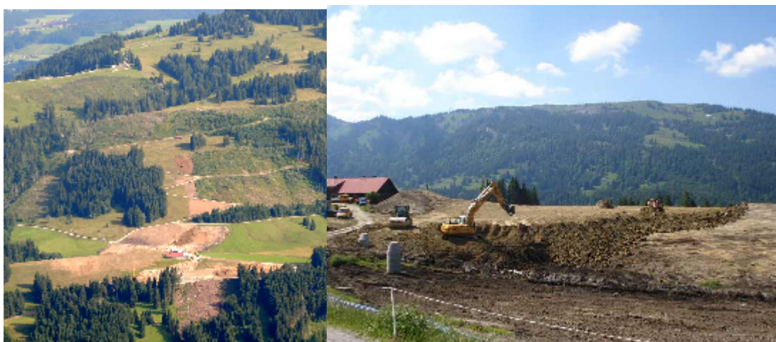
Bergwaldrodung, Pistenplanierung und Speicherteichbau im bisher touristisch extensiv genutzten Gunzesrieder Tal (Fotos BN)
