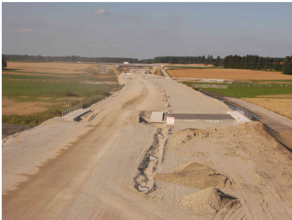
Östlichen Ende der Baustelle A94 mit Blickrichtung auf den Haager Forst Aufnahme August 2010. Foto: Margraf
